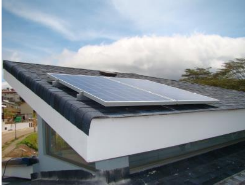
Vista de paneles solares
