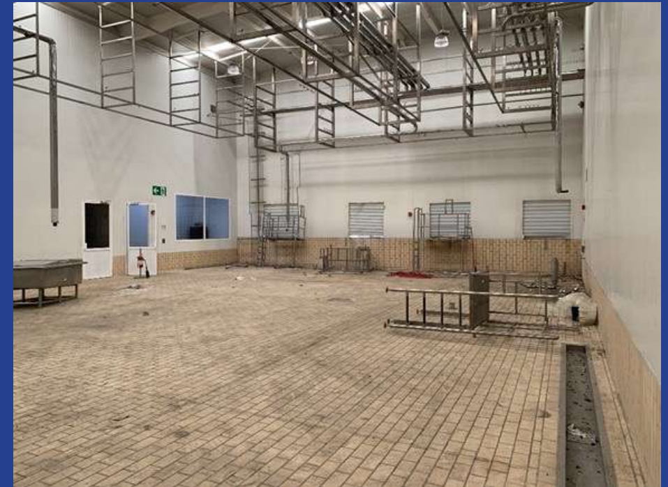
Fotografía 10. Zona Proceso (E).
