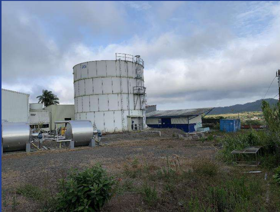
Fotografía 75. Tanque almacenamiento de agua.
