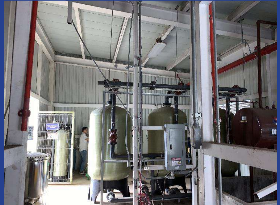
Fotografía 46. Cuarto de máquinas (Bombas) (BT).
