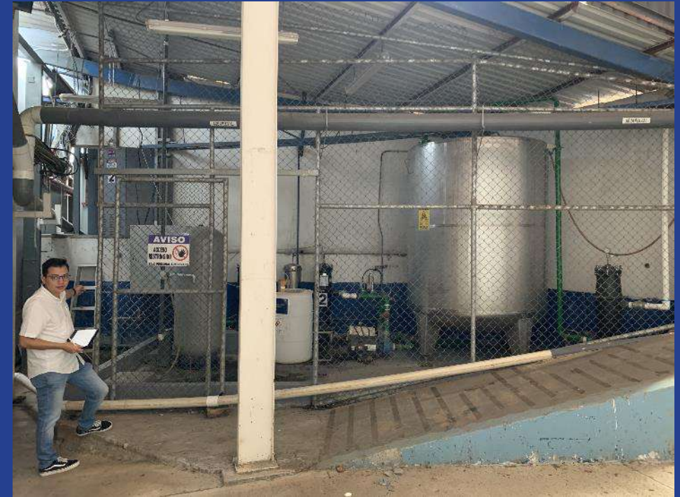
Fotografía 24. Zona tratamiento agua (Y).
