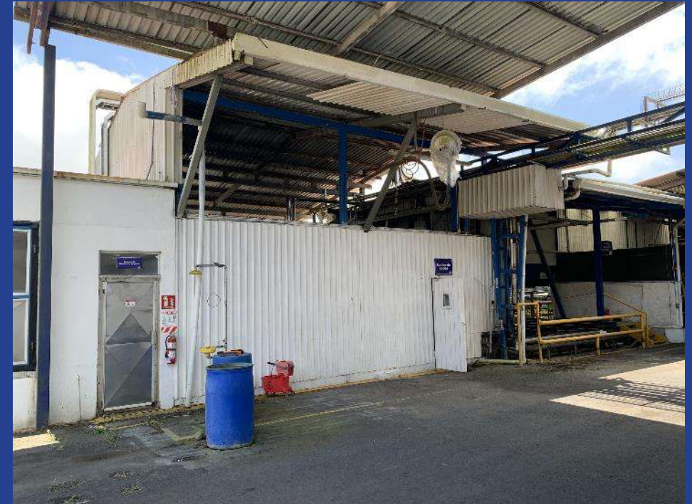
Fotografía 34. Recibo de leche (AN) y a la izquierda bodega de químicos temporal (AM).
