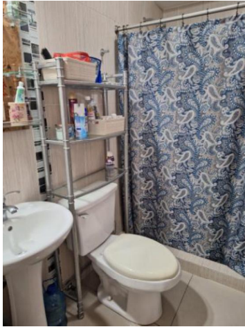
Servicio sanitario de uso múltiple.
