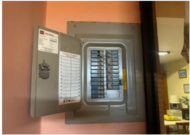
CAJA DE BREAKERS
