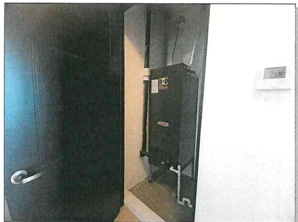
CUARTO No.2 DEL AIRE ACONDICIONADO CENTRAL
