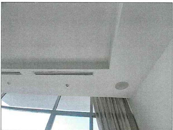
SISTEMA DE AIRE ACONDICIONADO CENTRAL
