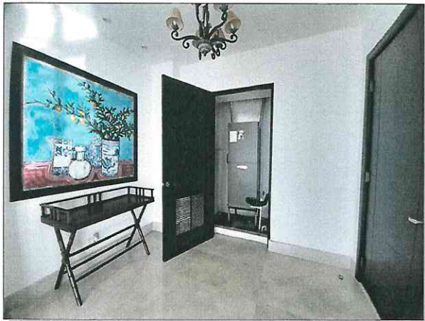
CUARTO No.1 DEL AIRE ACONDICIONADO CENTRAL
