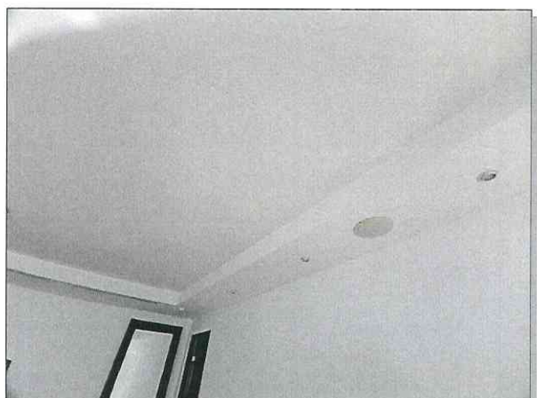
CIELO RASO DE GYPSUM CON LUCES EMBUTIDAS Y SONIDO INTEGRADO
