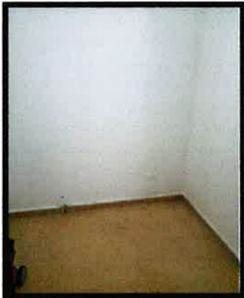
VISTA GENERAL DEL CUARTO DE USO DOMESTICO
