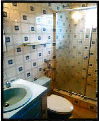
VISTA GENERAL DEL SERVICIO SANITARIO DE USO MULTIPLE
