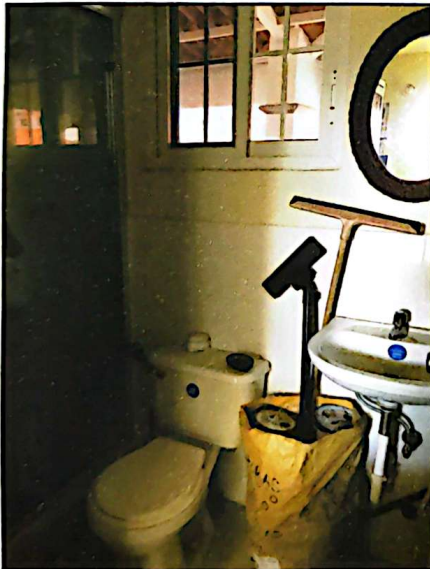
Vista del Servicio Sanitario de uso Domestico
