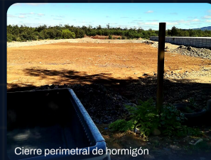
Cierre perimetral de hormigón
