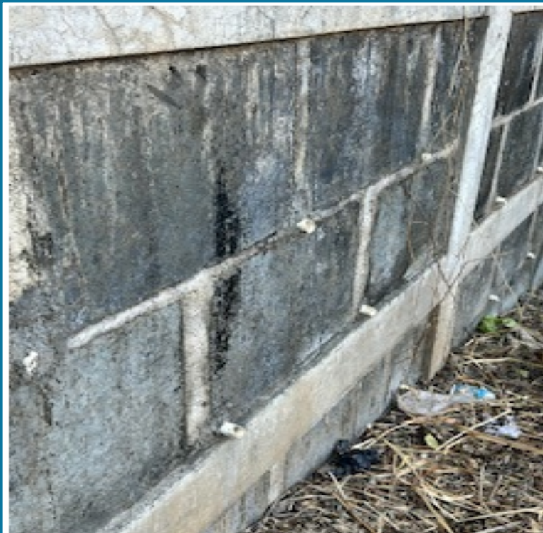
TODOS LOS MUROS TIENEN LLORONES DE PVC
