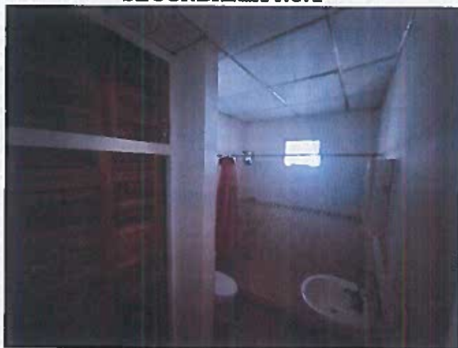
VISTA GENERAL DEL SERV. SANITARIO INTEGRADO DE LA REC. No.2
