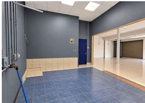
Área de trabajo con previstas de agua y electricidad
