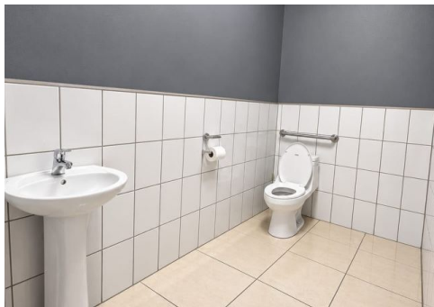
Baño accesible conforme a la Ley 7600
